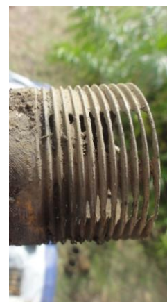
(d) Corroded pipe thread Source: Richard Carter.
